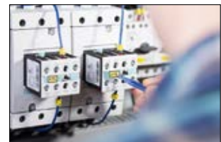
Sicherheit und Übersichtlichkeit im Schaltschrank mit HELASIGN-Etiketten.
